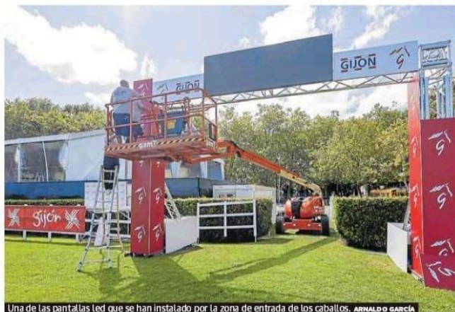
Una de las pantallas led que se han instalado por la zona de entrada de los caballos. ARNALDO GARCÍA
